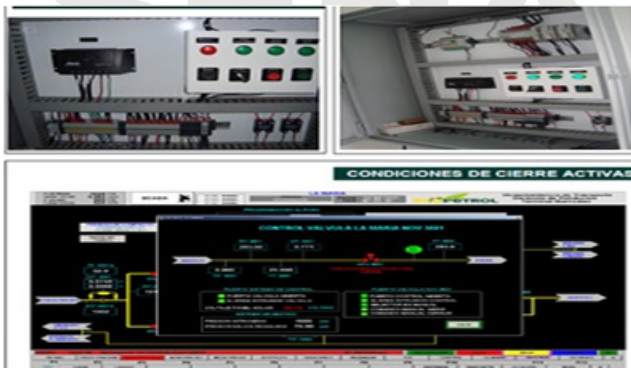
Figura 32. Tablero de control implementado en el proyecto e Interconexión del Sistema con el HDMI de Ecopetrol implementado en el proyecto
