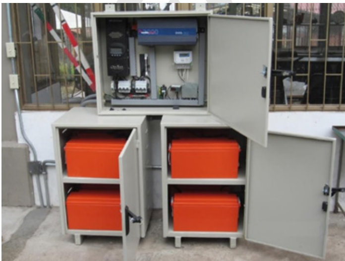
Figura 20. Equipos del sistema FV de 2.1KWp
